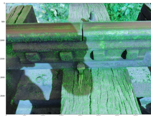
Gambar 14. Fitur SIFT pada rel non-defect.
