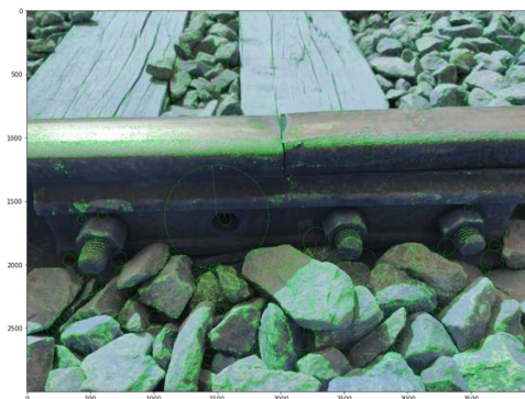
Gambar 13. Fitur SIFT pada rel defect.
